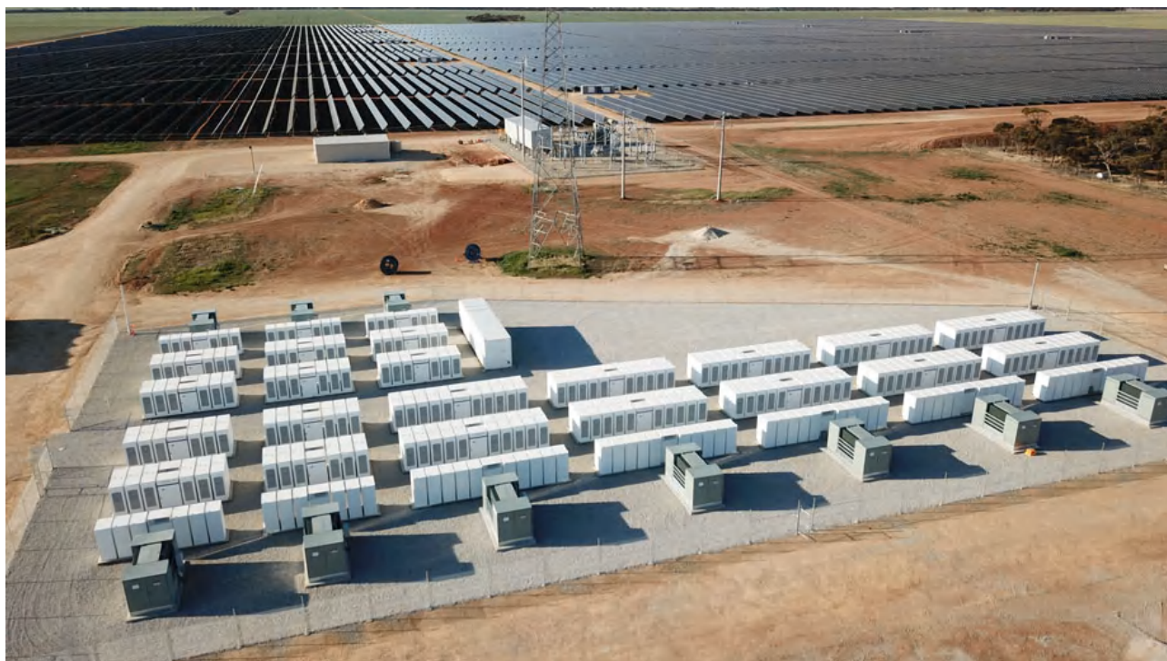
設於澳洲甘納瓦拉的大規模儲能電池。
