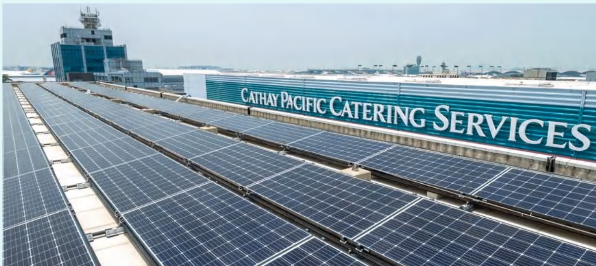
國泰航空飲食服務（香港）有限公司於其兩座生產大樓的天台上安裝面積達 3,000 平方米的太陽能電板。
