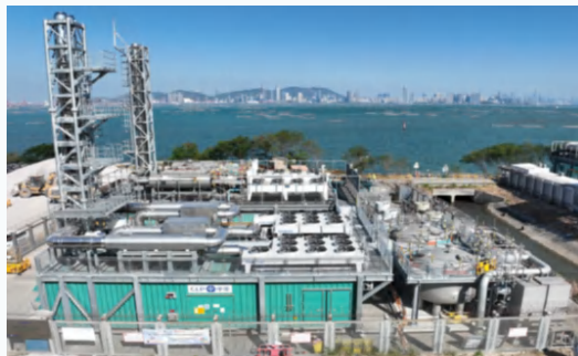
中華電力位於新界西堆填區的中電綠源。
